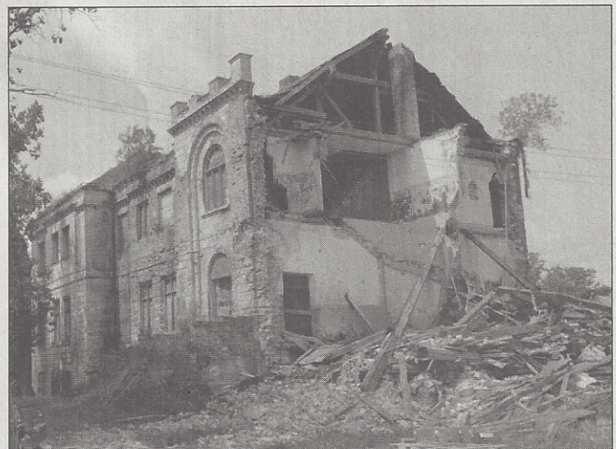
Das Gutshaus verfällt weiter. Es besteht kaum die Hoffnung, dass die noch stehende Ruine diesen Winter überstehen wird. Foto: V.G.
